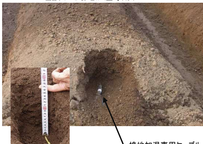
埋設した培地加温専用ケーブル
