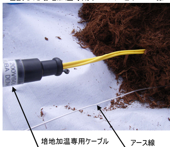
埋設した培地加温専用ケーブルとアース線
